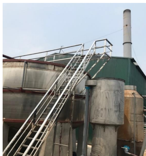
Hệ thống xử lý nước thải và nồi hơi
